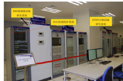
STATCOM、SVC、储能平台
