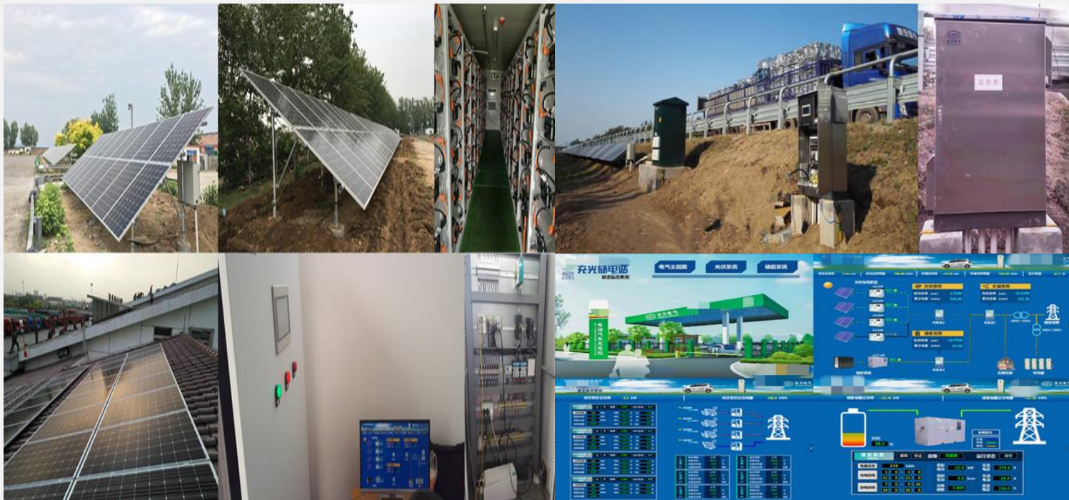
高速公路分布式光储电站
