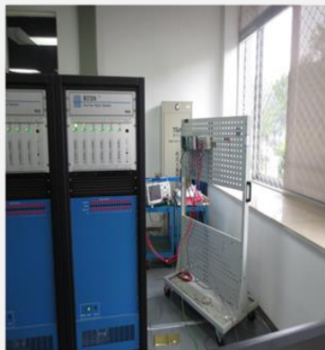
主控制器RTDS 硬件在环测试
